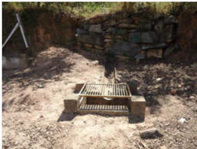
Figura 150. Canaleta de Águas Pluviais e Boca de lobo
