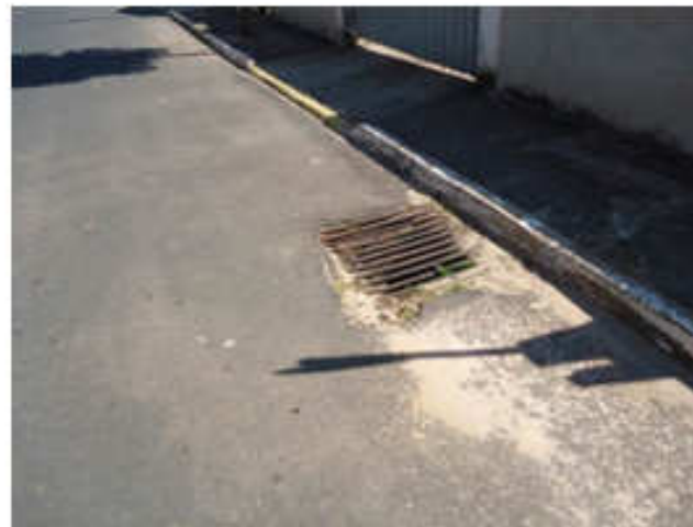
Figura 151. Boca de lobo existente no município de Monte Alegre do Sul
