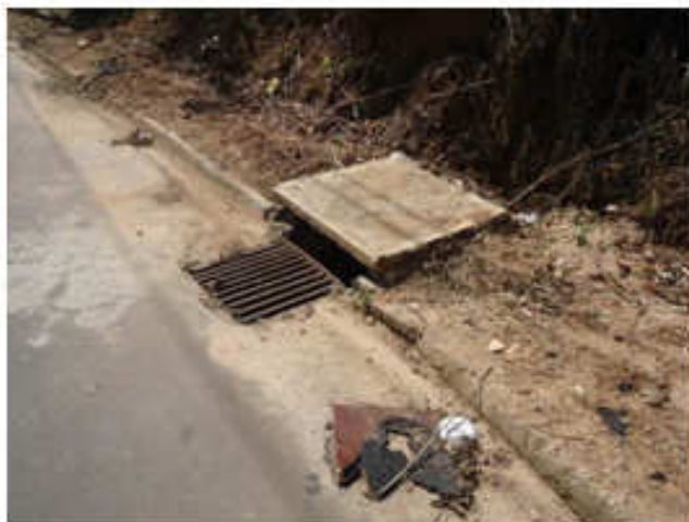
Figura 152. Boca de lobo existente no município de Monte Alegre do Sul
