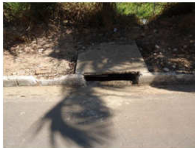
Figura 153. Boca de lobo existente no município de Monte Alegre do Sul
