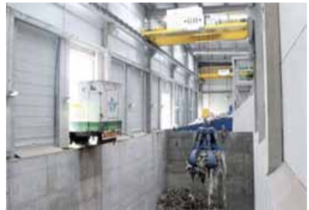
Figura 19 Recepção de RSU - galpão cerrado e túneis para compostagem
